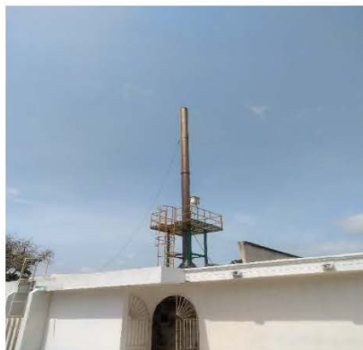
Chimenea y plataforma del horno crematorio de la empresa.
