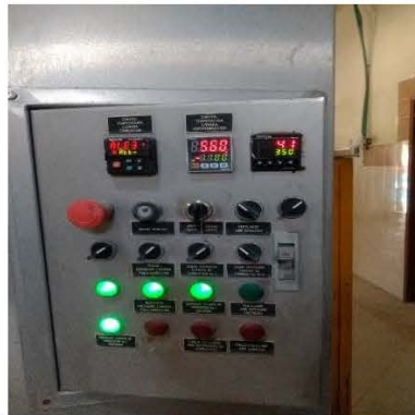
Foto 1. Tablero de controles del horno crematorio de la funeraria.
